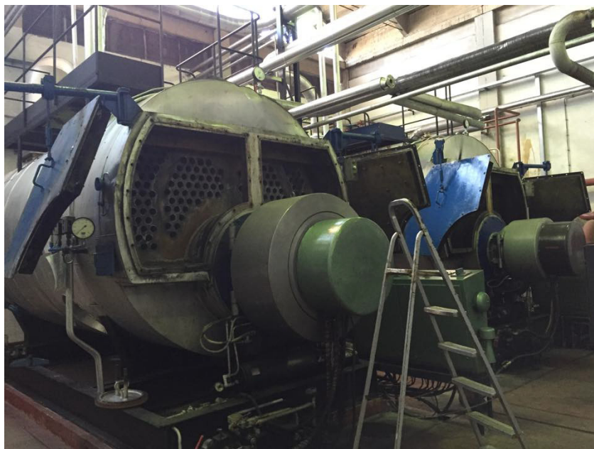
Slika 18. Postojeći parni kotlovi u Istarskoj pivovari
