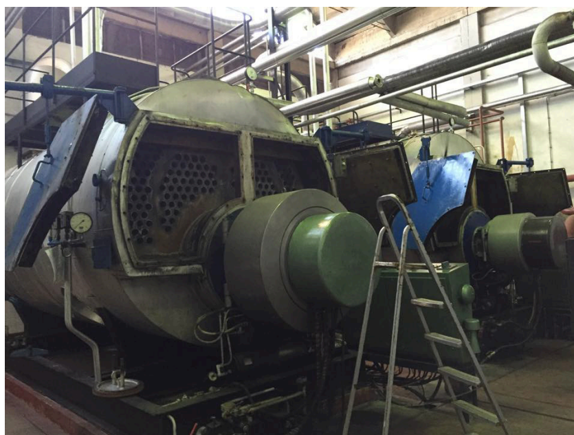
Slika 18. Postojeći parni kotlovi u Istarskoj pivovari
