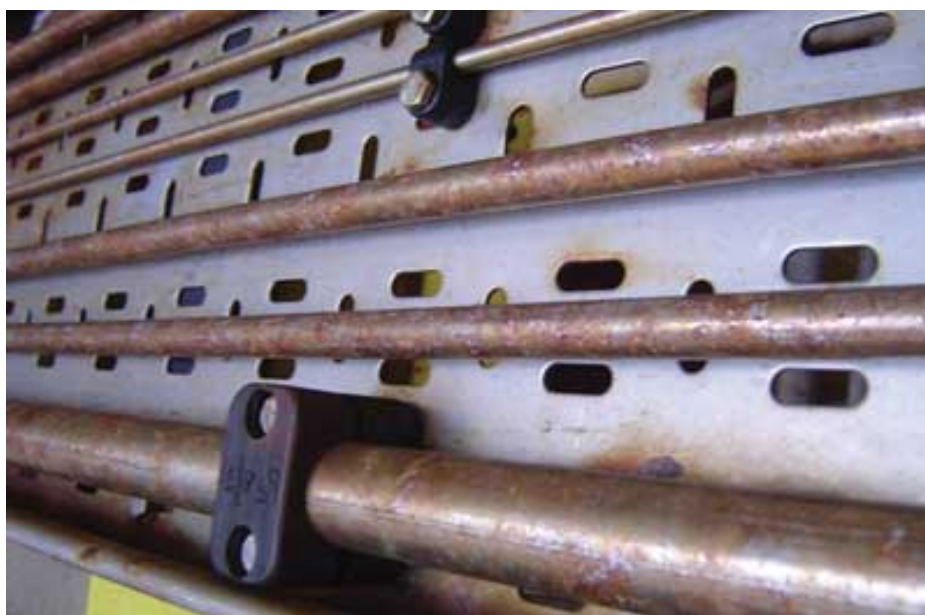
Slika 10. Korozija cjevovoda od nehrđajućeg čelika X2CrNiMo17-12-2 na off-shore platformi [13]
