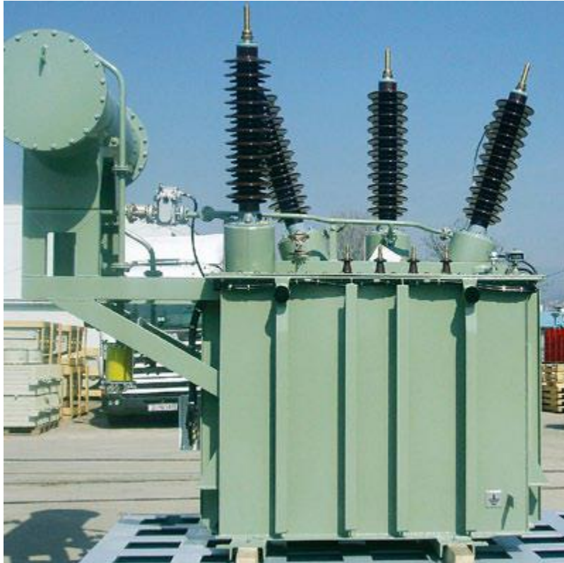
Slika 15. Primjer specijalnog transformatora. [24]
