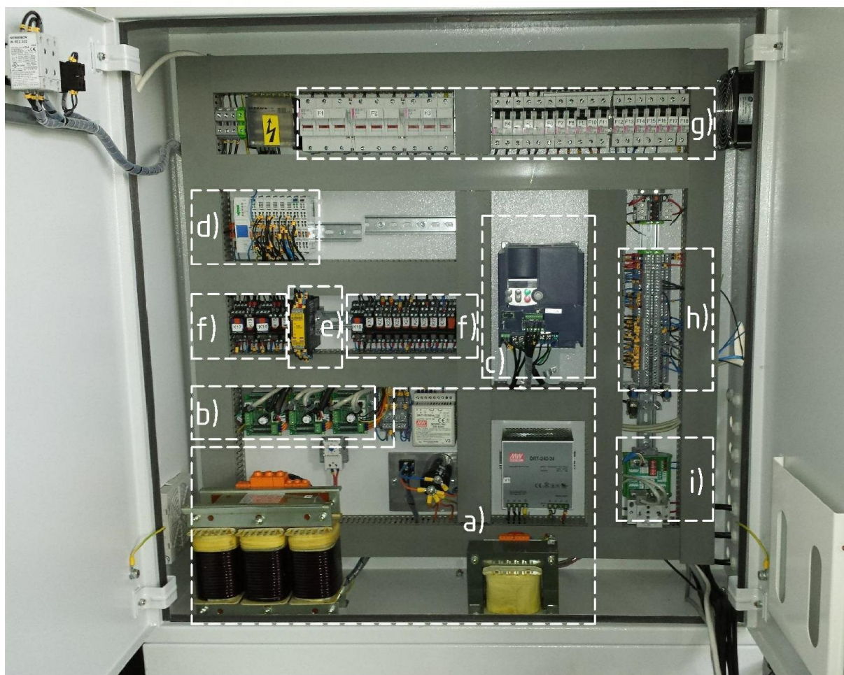
Slika 4.2 Elektro-ormar s označenim elementima sustava
