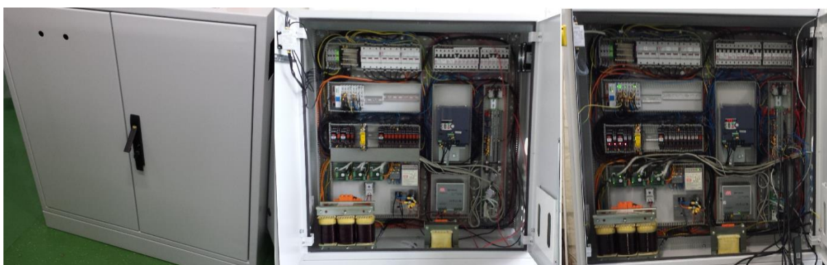
Slika 5.2 Elektro-ormar u različitim fazama izrade
