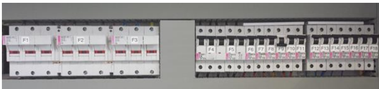
Slika 4.23 Zaštitne sklopke elemenata elektro-ormara
