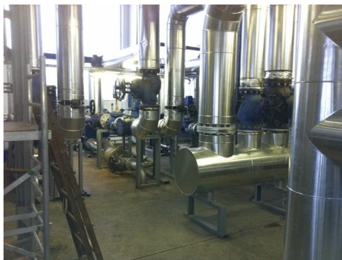
Slika 18. Prikaz centralne toplinske stanice na lokaciji Rebro
