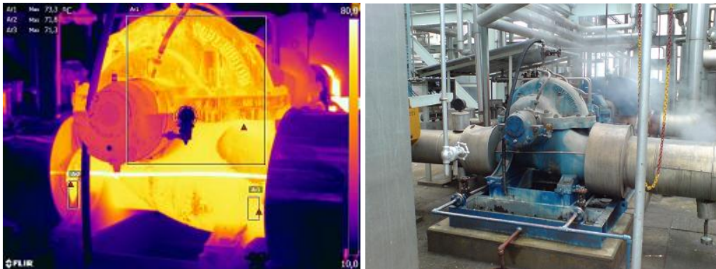
Slika 10. Pumpa s ulaznim i izlaznim cjevovodom
