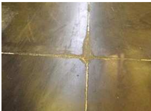
Slika 48. Neravnine na voznoj površini [33]
