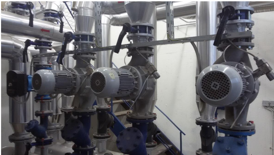
Slika 13. Pumpe i motori
