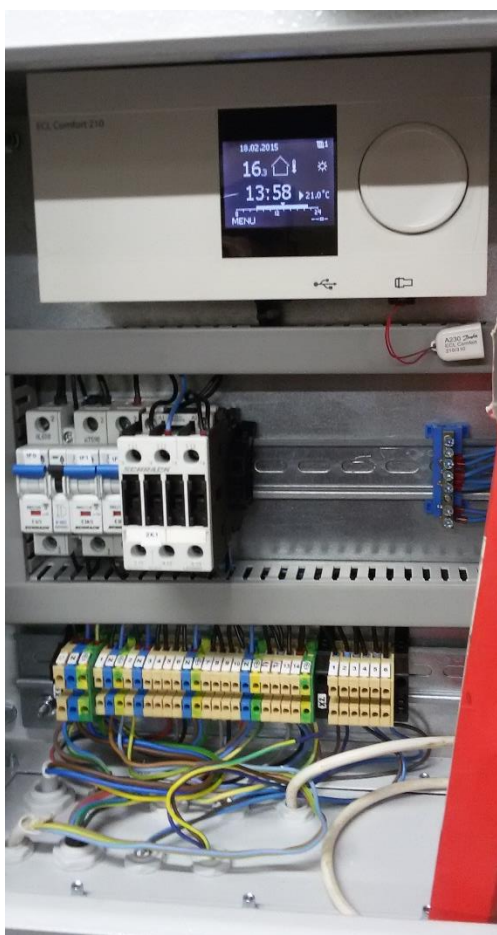
Slika 9. Kontrolno sučelje izmjenjivača topline
