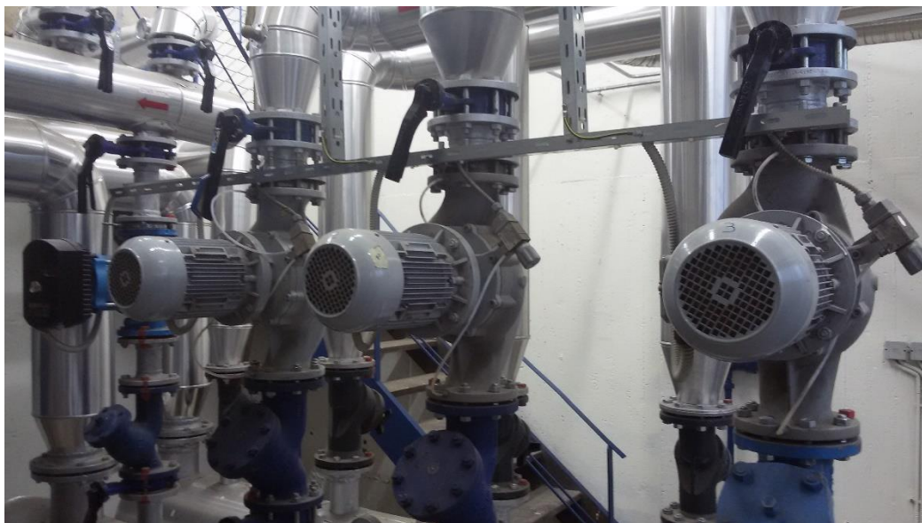
Slika 13. Pumpe i motori
