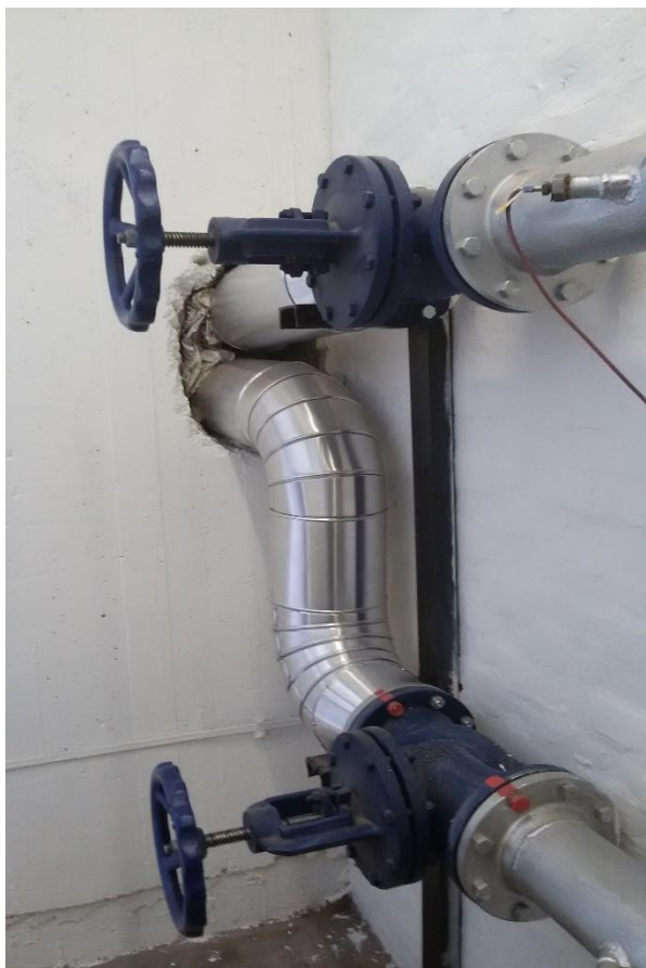
Slika 4. Glavni ventili toplinske mreže
