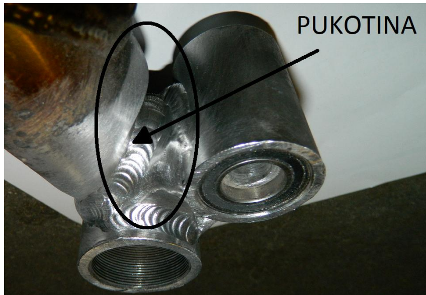
Slika 18. Pukotina na rubu zavora
