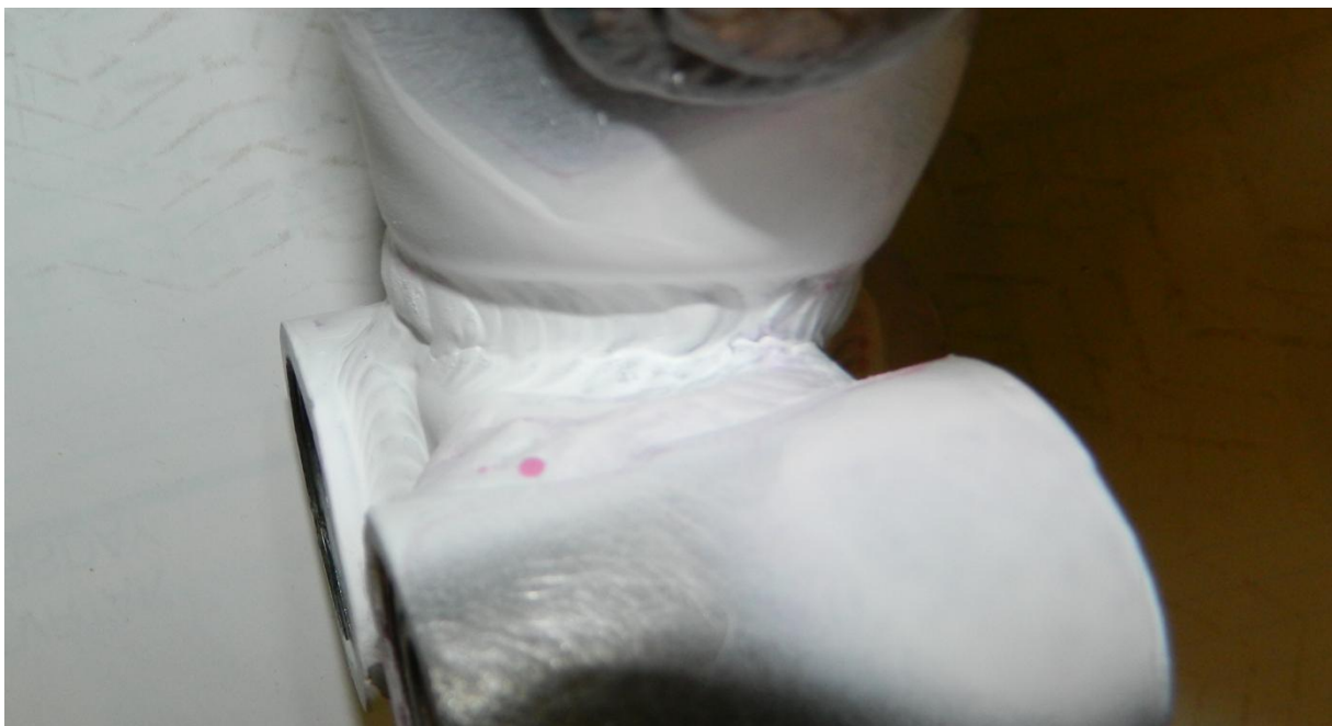
Slika 32. Indikacija pukotine nakon nanošenja razvijачa
