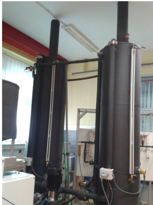
Slika 12. Topli i hladni spremnik vode
