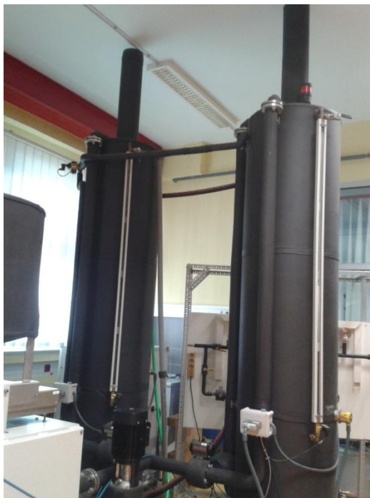
Slika 12. Topli i hladni spremnik vode
