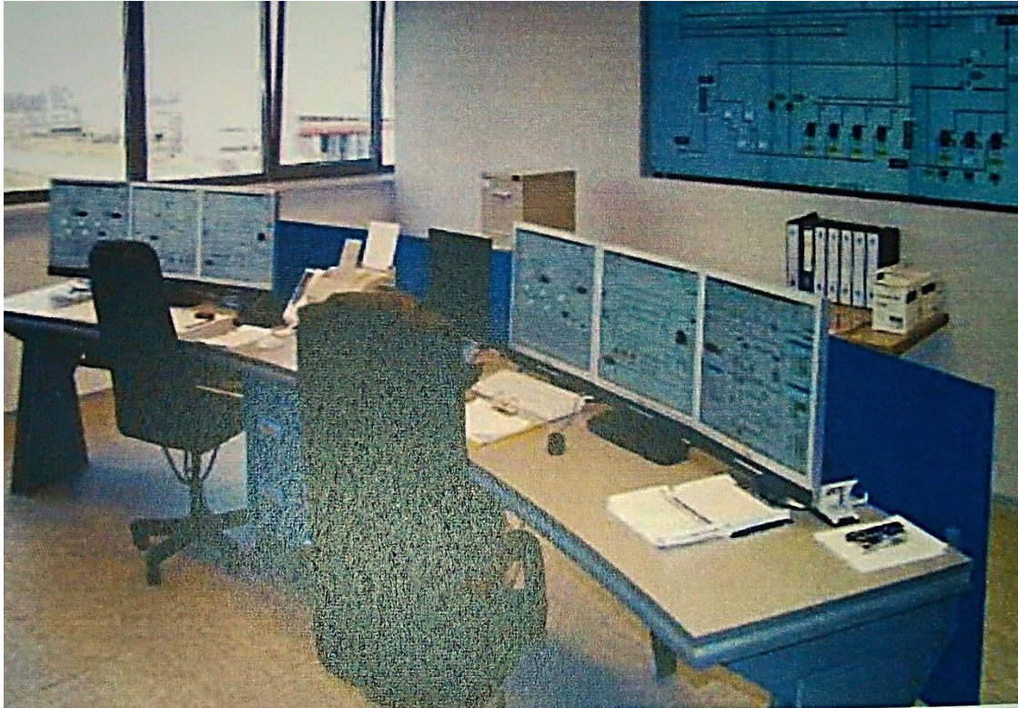
Slika 29. Kontrolni centar SCADA u Sisku
