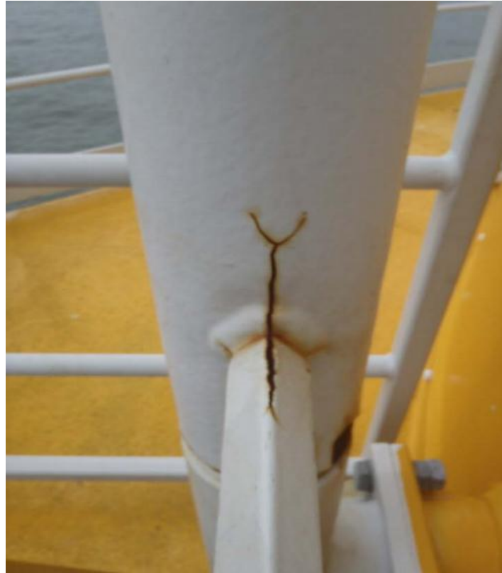
Slika 19. Nastala pukotina premaza [16]
