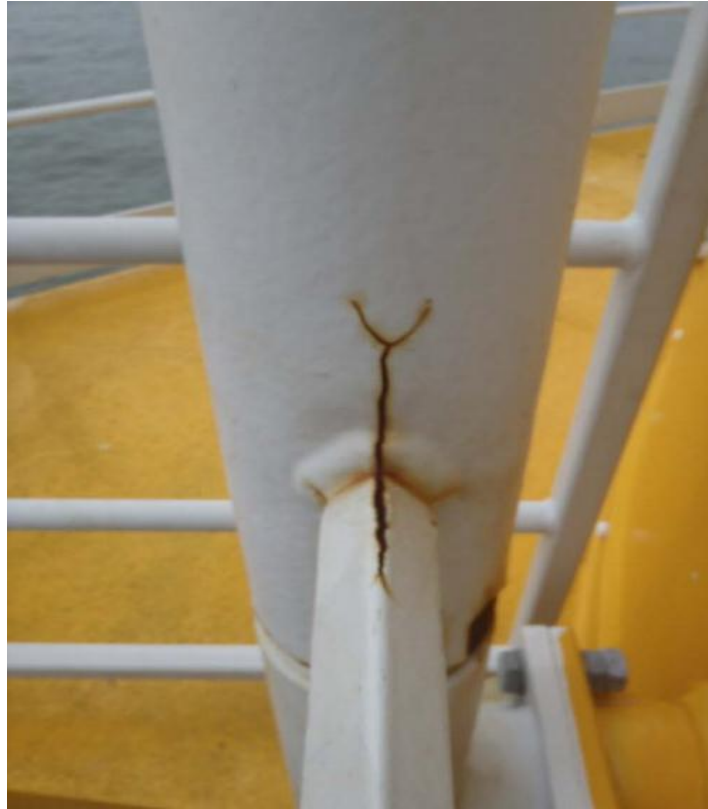
Slika 19. Nastala pukotina premaza [16]
