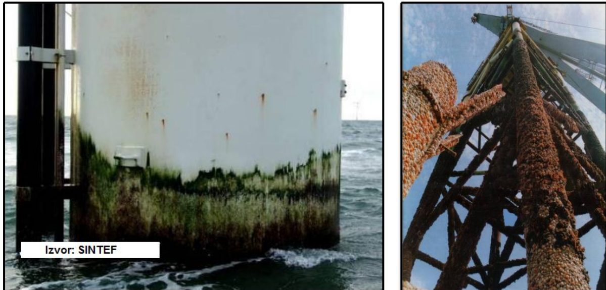
Slika 11. Oštećenje konstrukcije u zoni valova [12]
