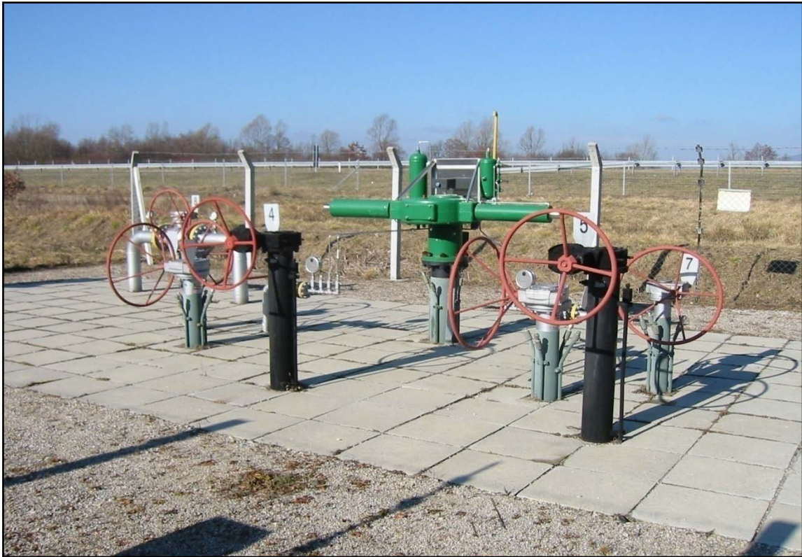
Slika 6. Blokadna stanica Jastrebarsko
