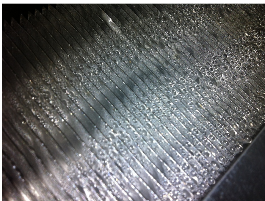
Slika 85. Prikaz kondenzata na lamelama izmjenjivača
