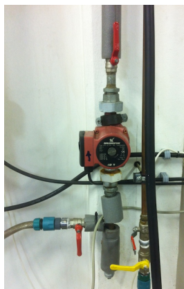
Slika 27. Cirkulacijska pumpa primarnog rashladnog kruga
