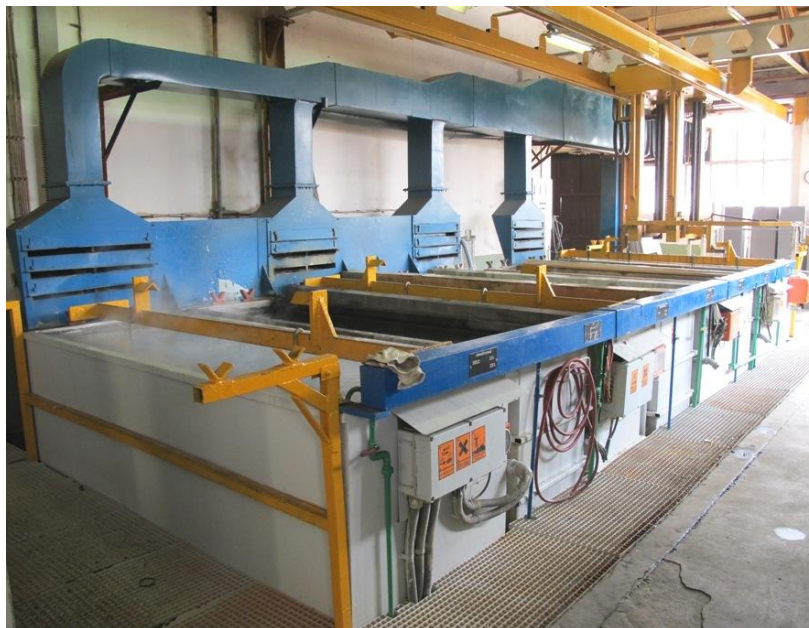
Slika 11. Prikazuje kade za tehnološki proces kemijske predobrade usmjeren na slici s desna na lijevo u tvrtki „KONČAR Sklopna postrojenja“ [10]
