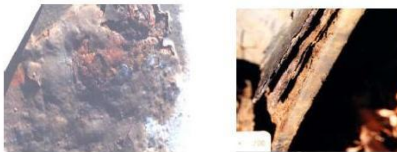
Slika 6. Bubrenje i listanje materijala kod potpovršinske korozije [3]
