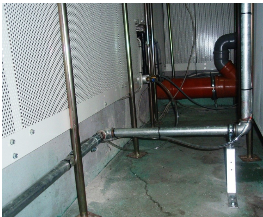
Slika 4.8. Razvod hidrauličke instalacije do ulaza u kočnicu
