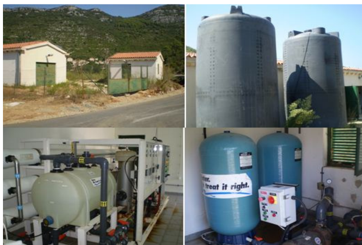
Slika 13. Desalinizacijsko postrojenje na Mljetu-postrojenje Blato (31)
