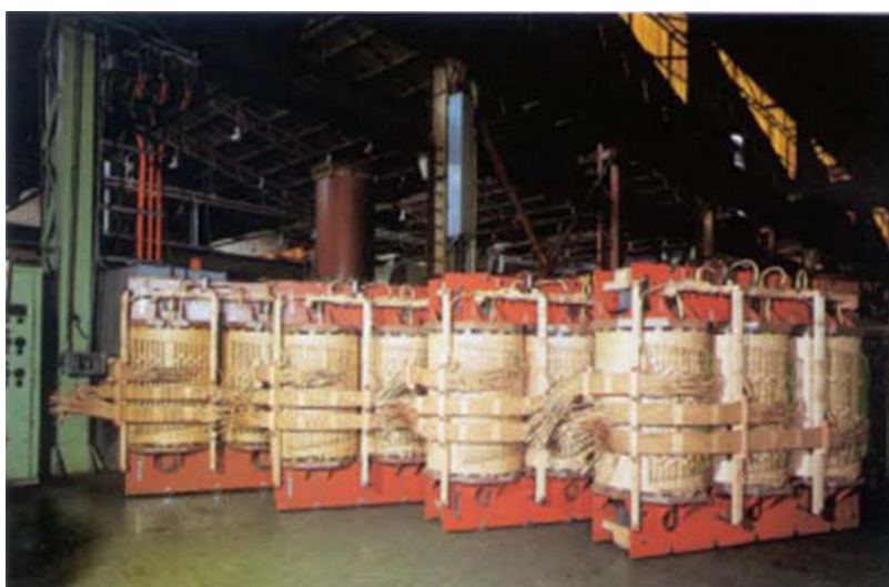
Slika 3. Energetski transformatori – jezgre s namotima
