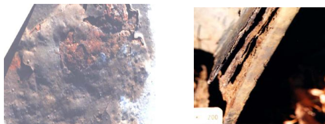
Slika 5. Bubrenje i listanje materijala kod potpovršinske korozije [4]
