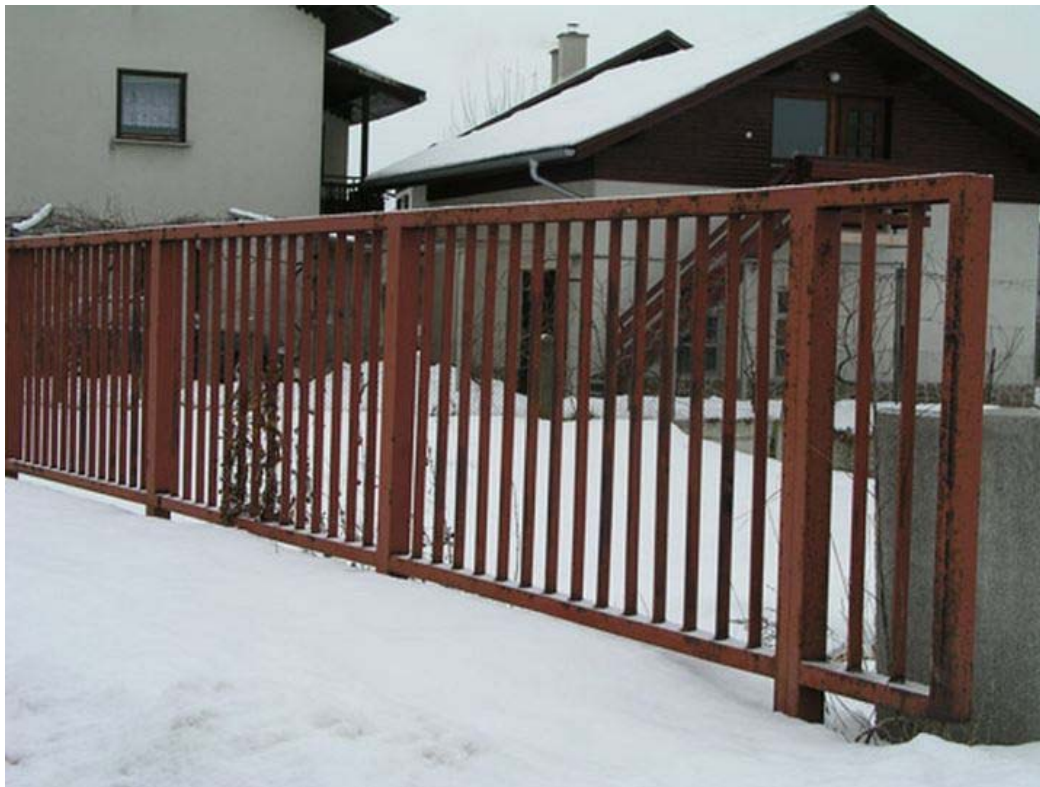
Slika 4.1. Pojava korozije na metalnoj ogradi
