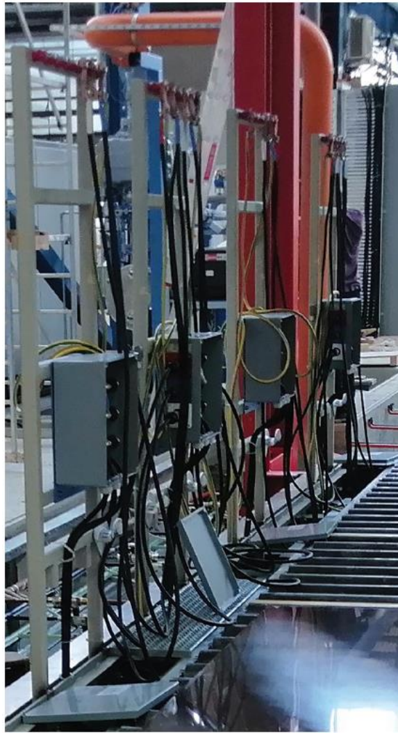
Slika 25. Pultovi za ispitne kablove
