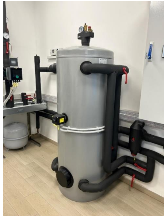
Slika 8. Prikaz spremnika vode uz DT
