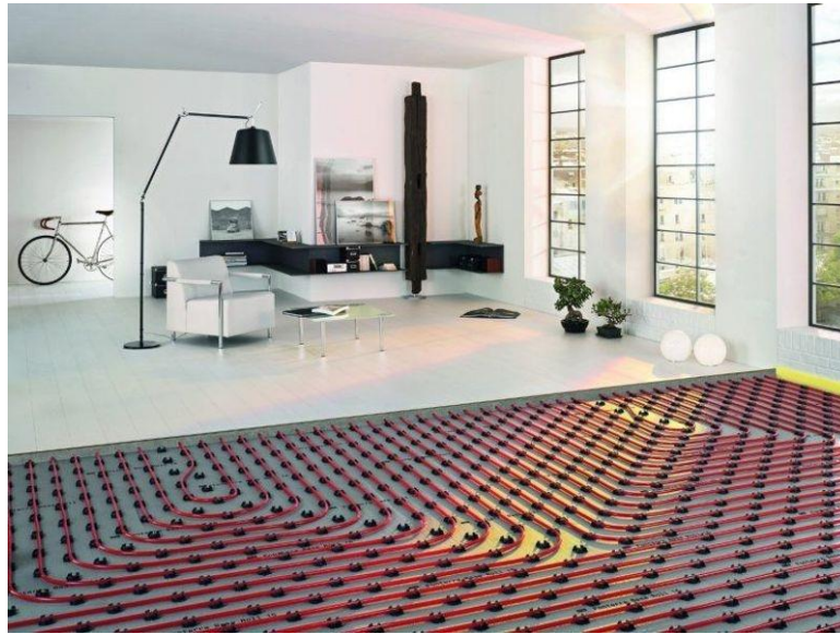
Slika 4. Cijevne petlja podnog grijanja i hlađenja [8]
