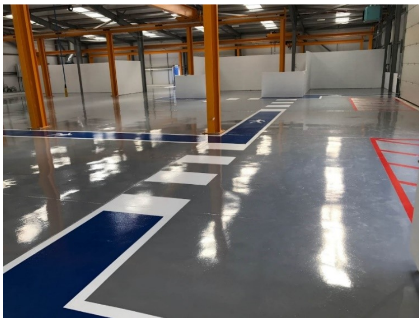
Slika 13. Epoksidni pod u skladištu [26]
