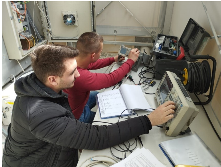
Slika 22. Ispitivanje stanja mjernih i izvršnih elemenata posmičnih i glavnog prigona
