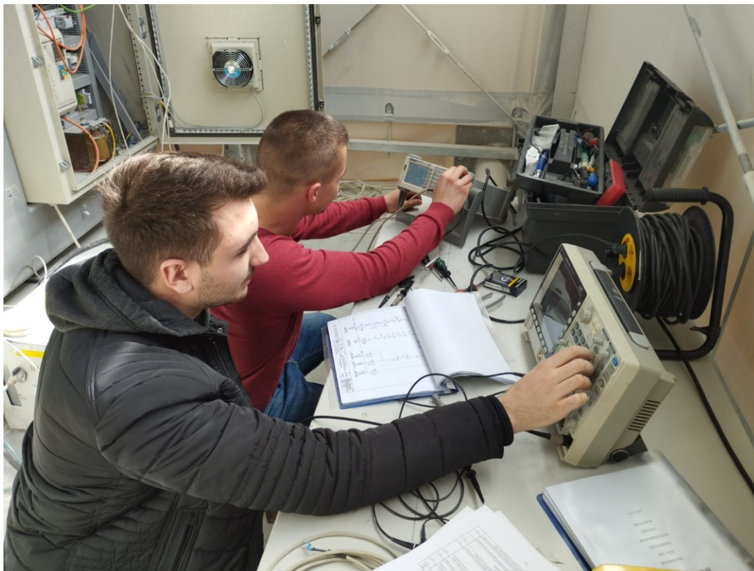
Slika 19. Ispitivanje pogonskih sustava posmičnih i glavnog prigona
