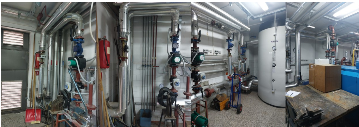
Slika 7. Prikaz postojećeg dijela strojarnice
