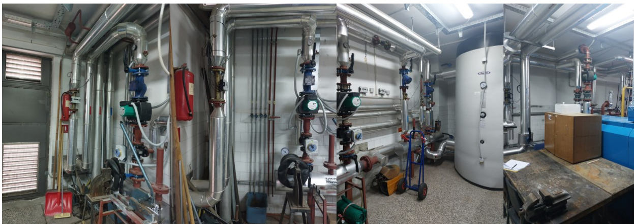
Slika 7. Prikaz postojećeg dijela strojarnice
