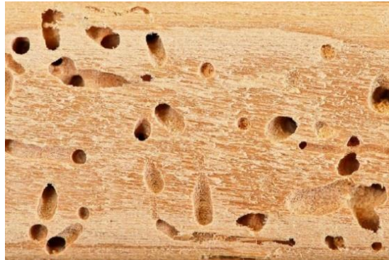
Slika 14. Oštećenja u drvu nastala djelovanjem termita [22]
