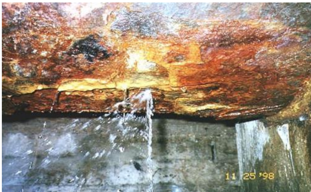
Slika 1. Šteta uzrokovana korozijom cjevovoda [4]
