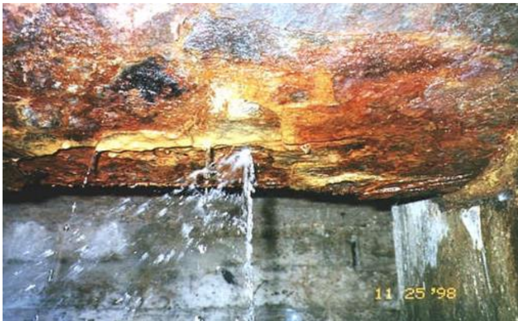
Slika 1. Šteta uzrokovana korozijom cjevovoda [4]
