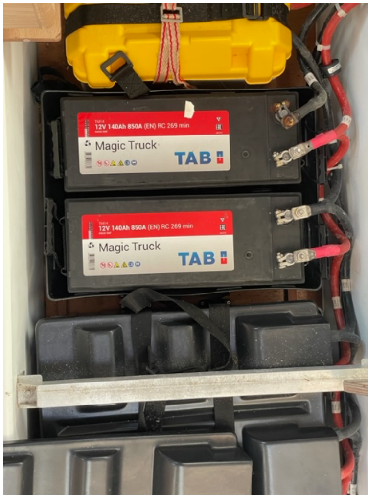
Slika 22. Trenutne kućne baterije
