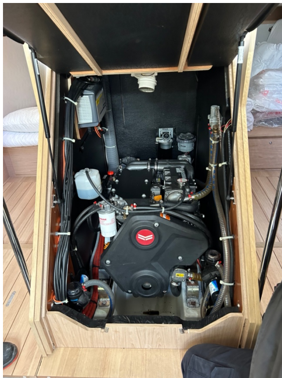
Slika 27. Dostupan prostor u unutrašnjosti motornog prostora
