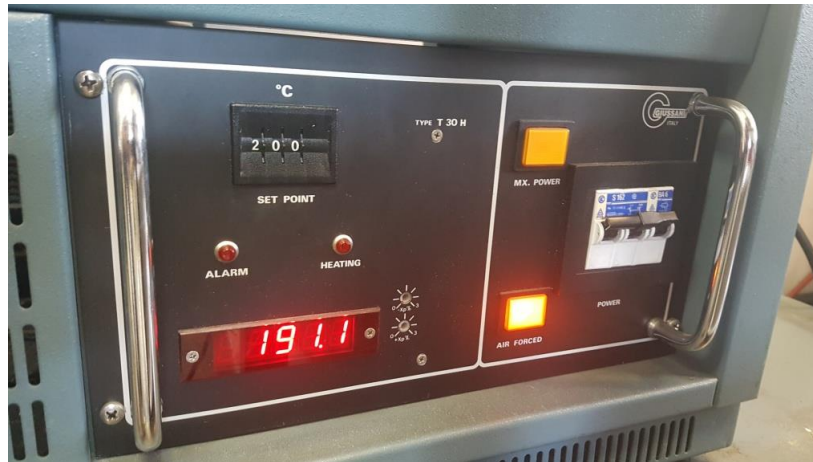
Slika 15: Tvornički ugrađen regulator
