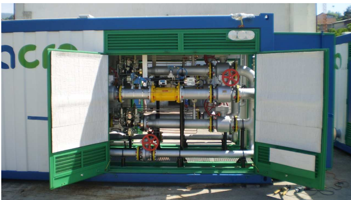
Slika 13. Tipska mjerno-redukcijska stanica
