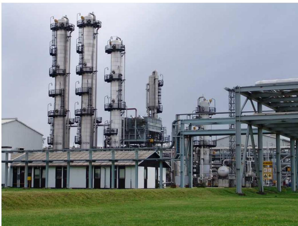
Slika 6. Centralna plinska stanica Molve
