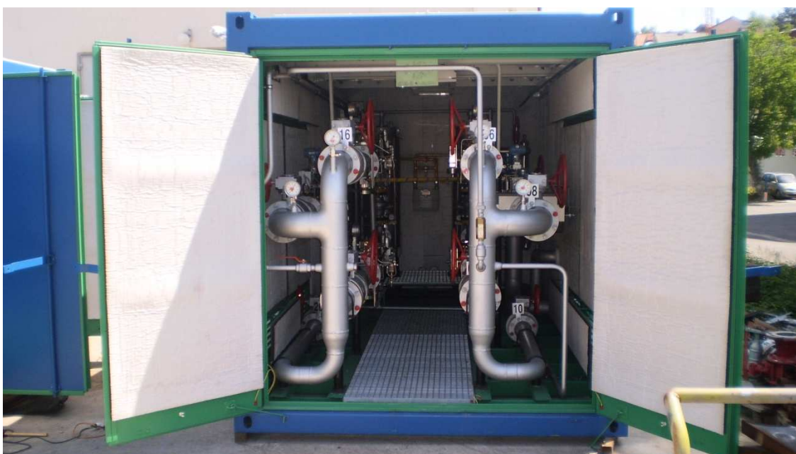
Slika 14. Unutrašnjost tipske mjerno-redukcijske stanice
