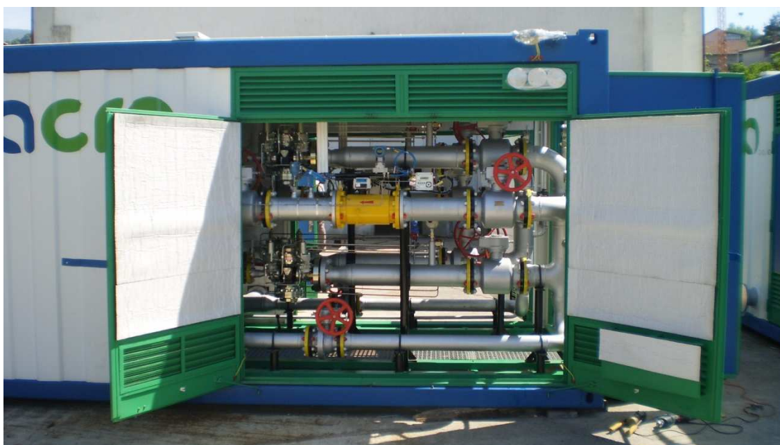
Slika 13. Tipska mjerno-redukcijska stanica
