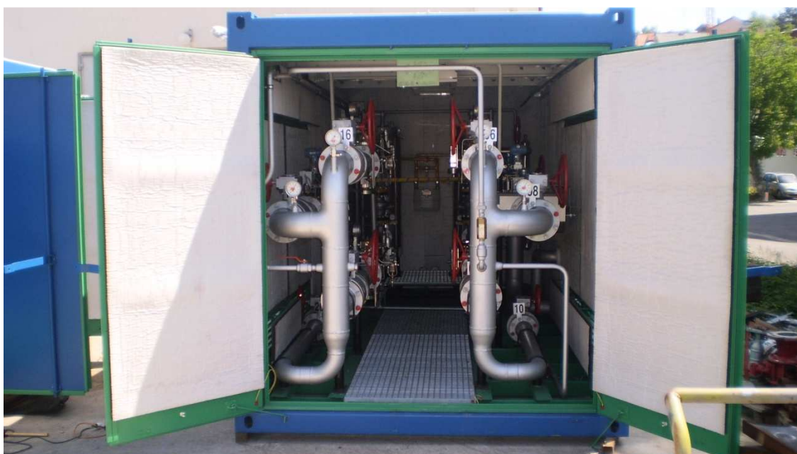
Slika 14. Unutrašnjost tipske mjerno-redukcijske stanice
