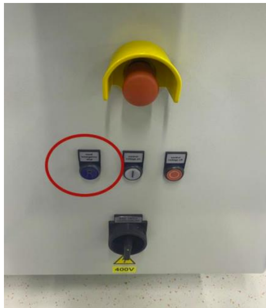
Slika 18. Uključivanje glavnog PLC-a.
