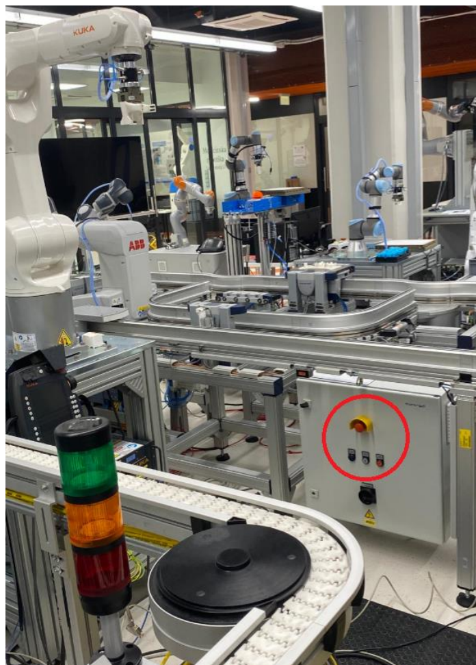
Slika 17. Lokacija upravljačke jedinice.
