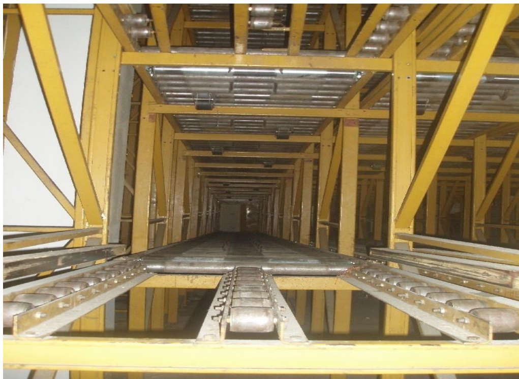
Slika 20. Tuneli valjčanih traka u skladištu
