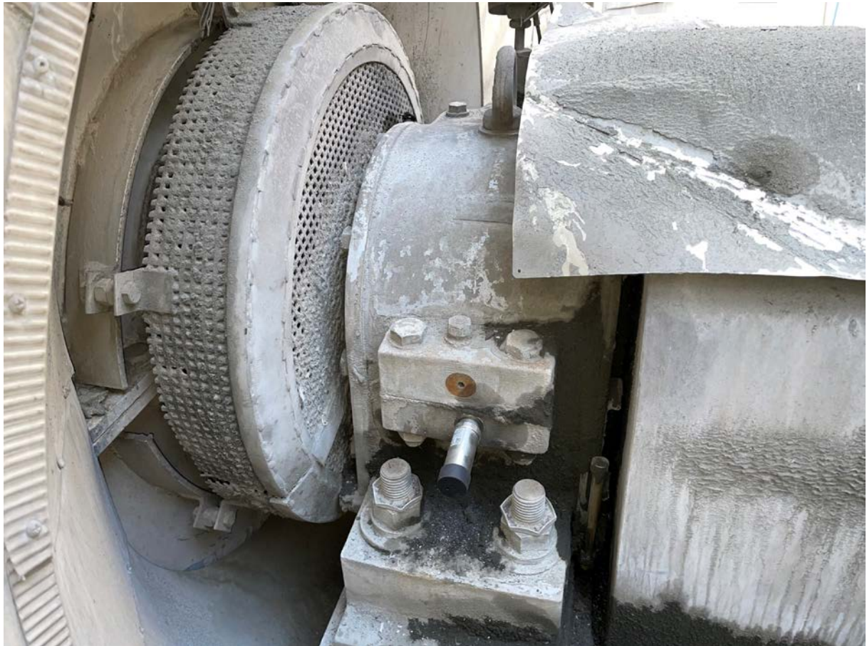
Slika 36. Montirani senzor na ležaju ventilatora [11]
