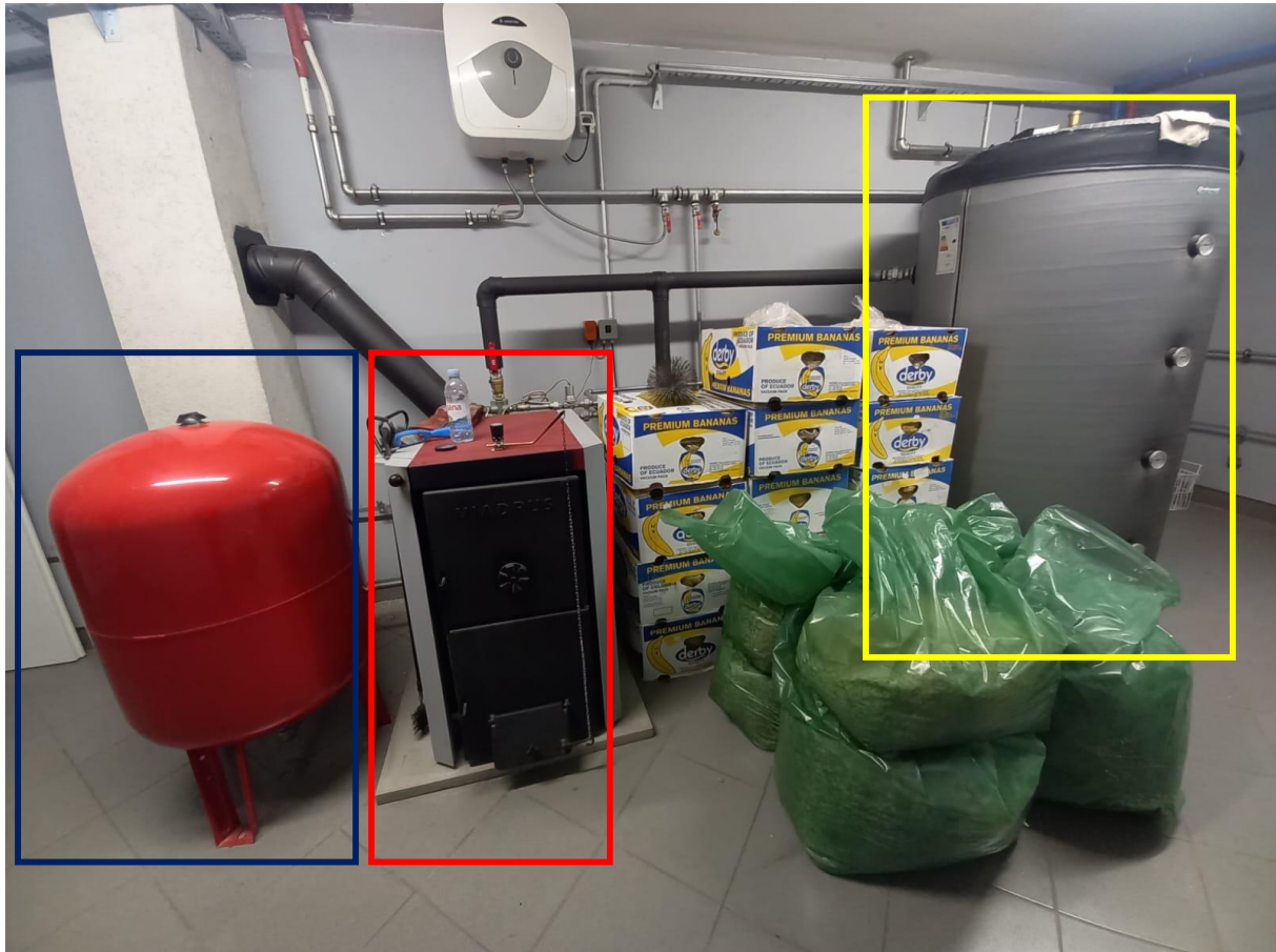
Slika 1 Postojeći sustav centralnog grijanja
