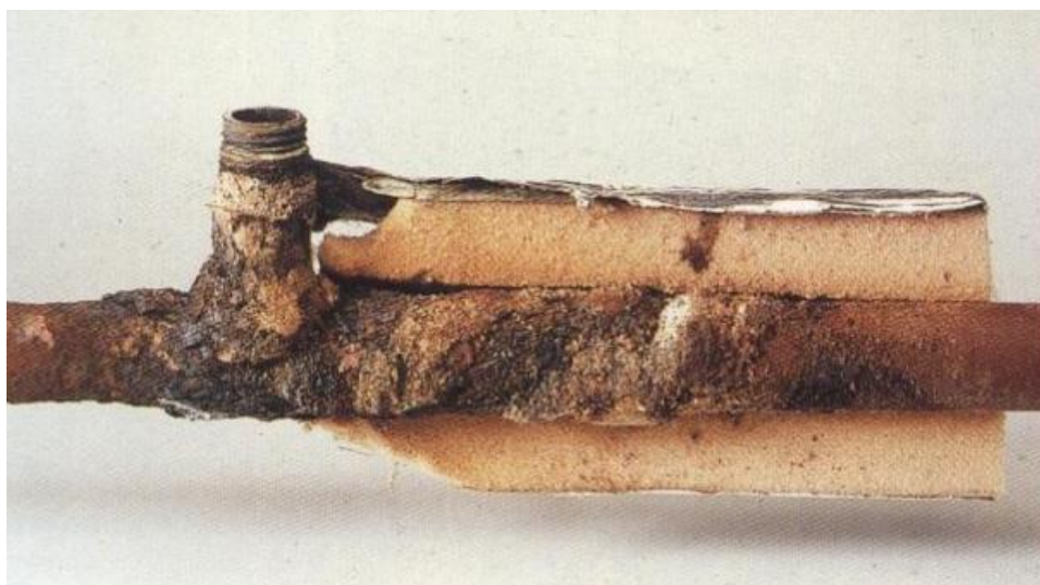
Slika 3. Korozija u procijepu [9]
