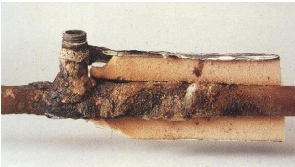
Slika 3. Korozija u procijepu [9]
