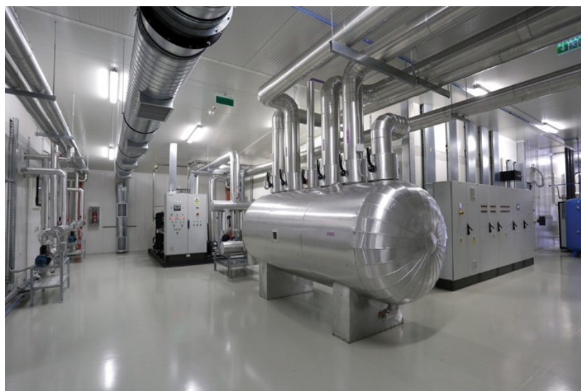
Slika 1. Industrijsko rashladno postrojenje
