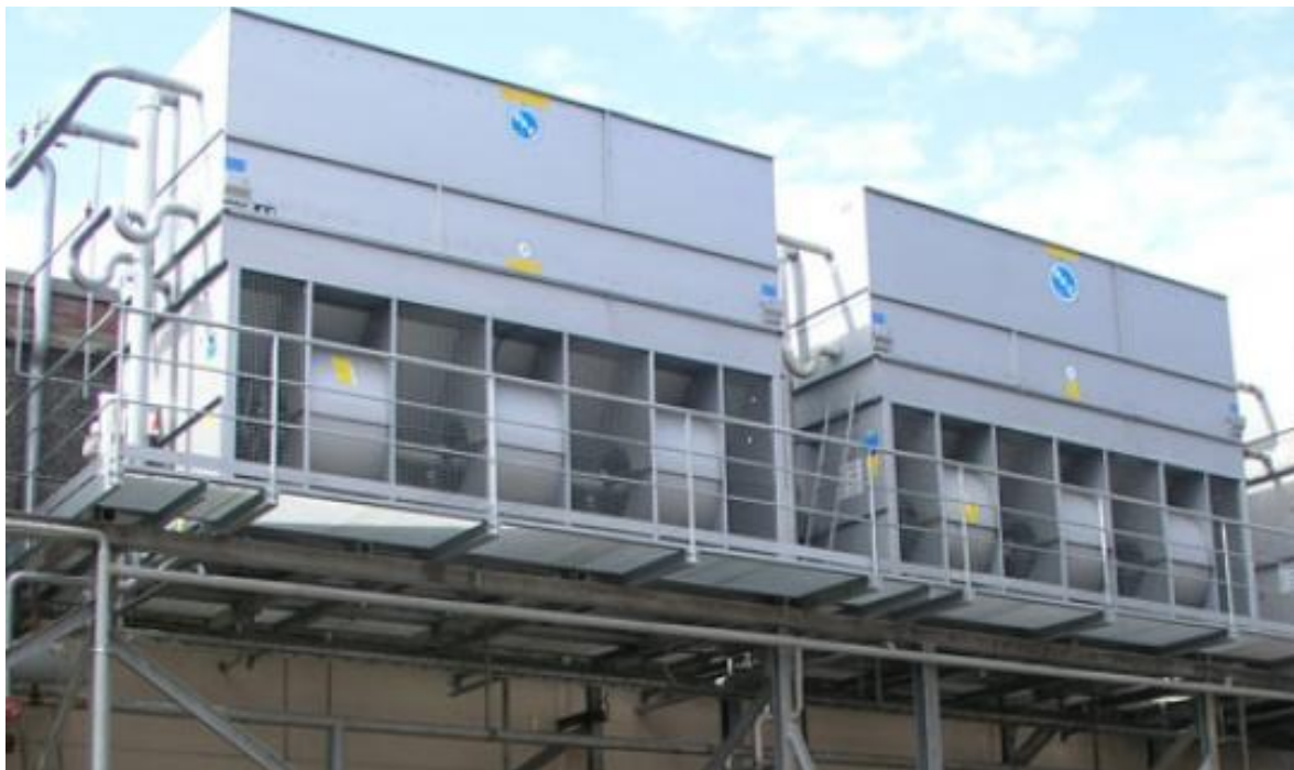
Slika 4. Evaporativni kondenzator BALTIMORE [2]
