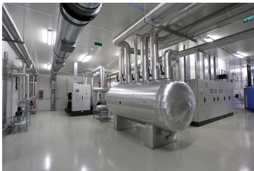
Slika 1. Industrijsko rashladno postrojenje
