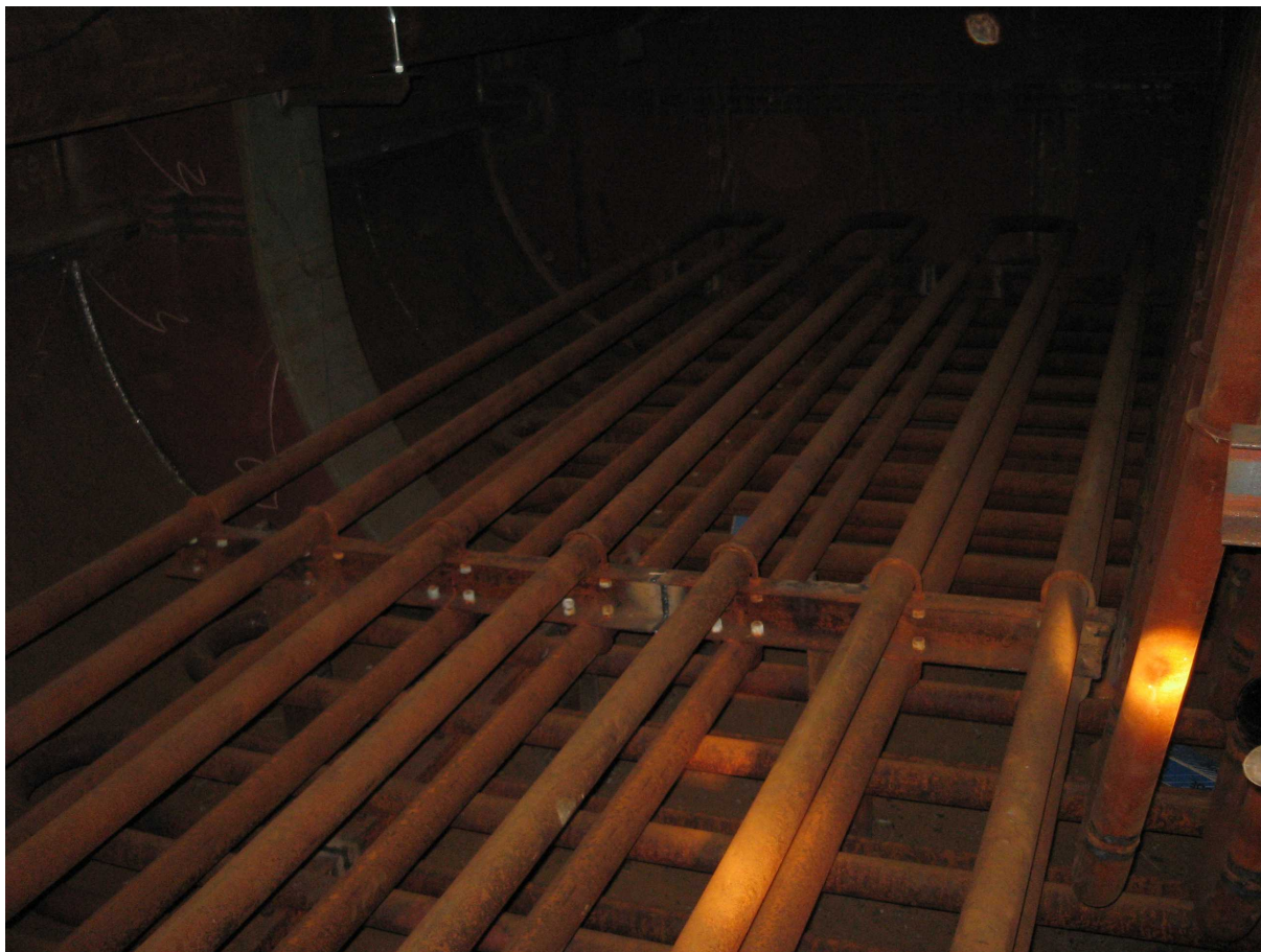
Slika 68 Fotografija serpentina montiranih na dno svakog spremnika
