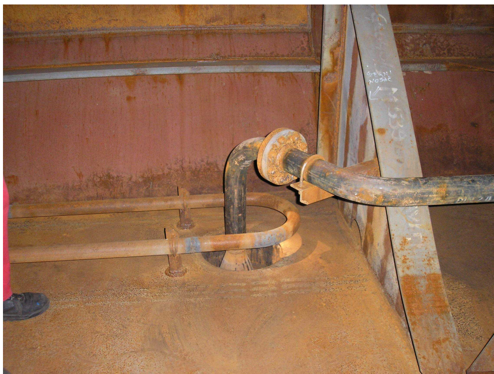
Slika 102 Zdenac i cijev za isušivanje ostatka tekućeg tereta u spremnicima
